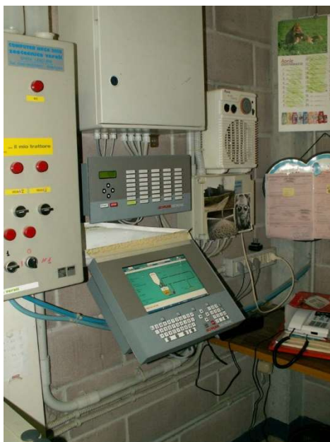
Controllo remoto da pc (capannone 1)
