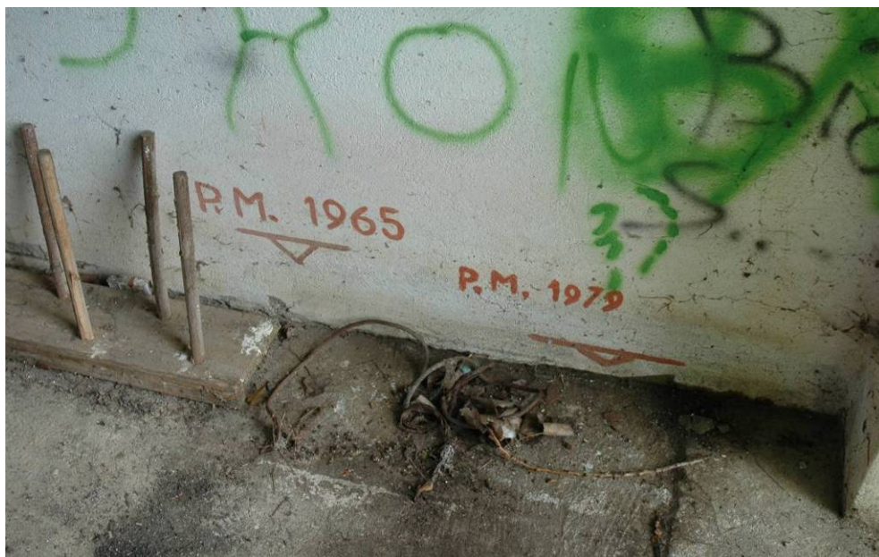
Figura 6.10.3: livelli massimi raggiunti dalle piene del 1965 e del 1979, rispettivamente 23 e 9 cm dal pavimento
