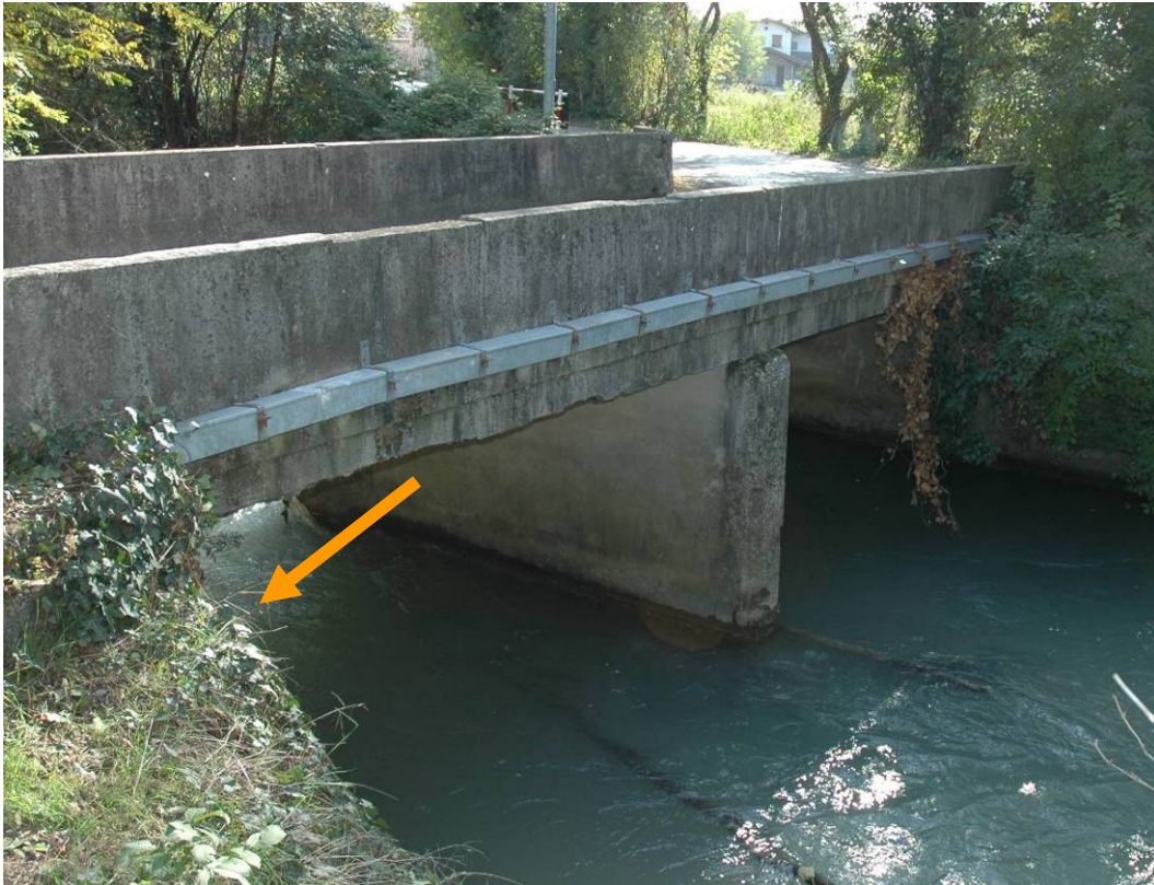
Figura 6.3.2: ponte sul torrente Corno in località Zompicchia (Comune di Codroipo). La freccia indica il punto dove è stato posizionato l'idrometro
