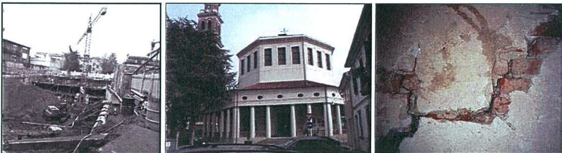
1995: scavi per la costruzione di un parcheggio sotterraneo Chiesa della Rotonda e altri monumenti danneggiati
