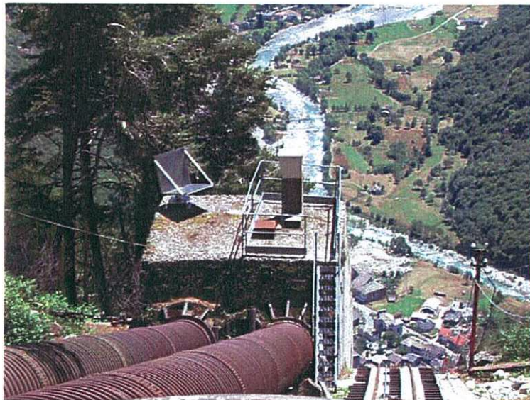
Figura 27: Riflettori artificiali (di tipo diedro rettangolare) per il monitoraggio della stabilità di una struttura (condotta forzata) in ambiente montuoso.
