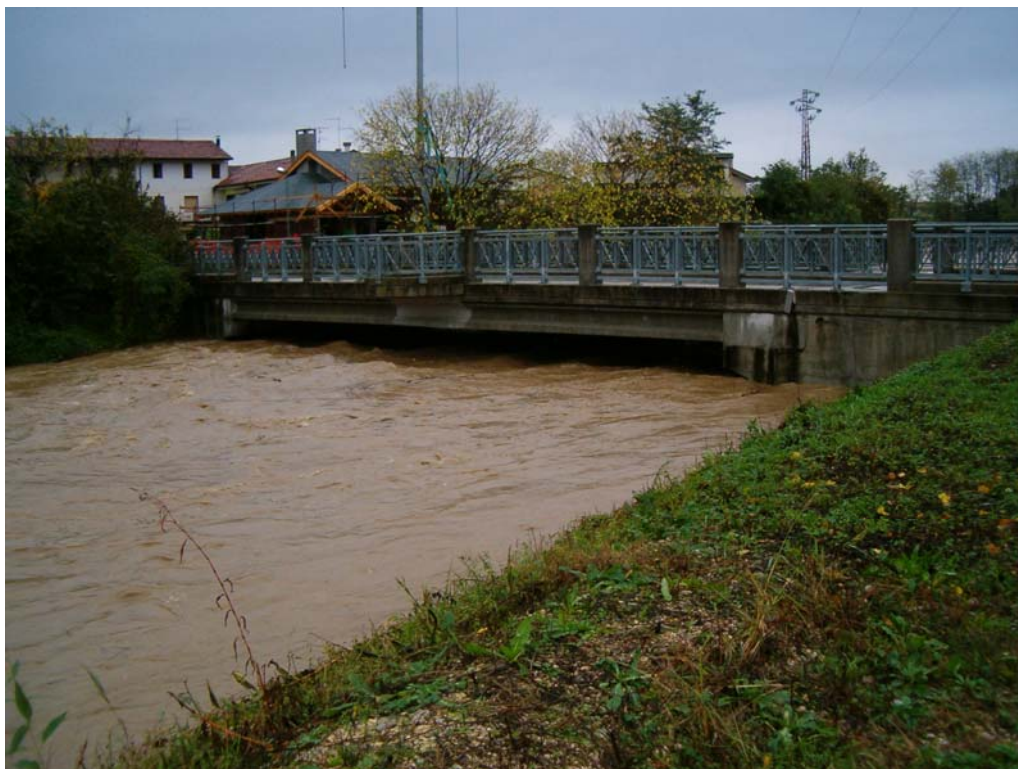
Figura 8.7.12: Ponte di Basaldella in occasione della piena del 31.10.2004.
