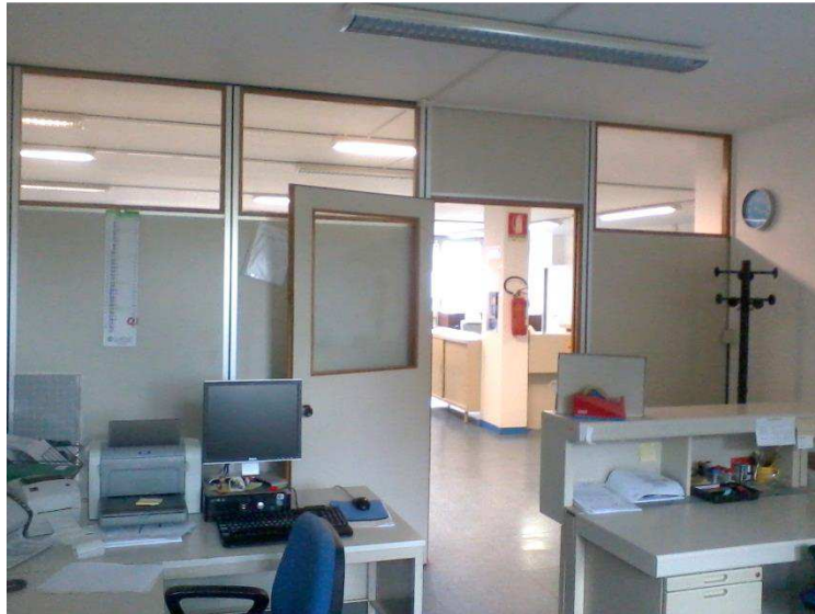
Parete divisoria da sostituire con tramezzatura REI
