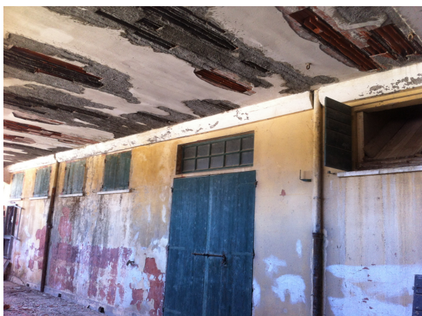
Immagine: solaio portico sfondellamento
